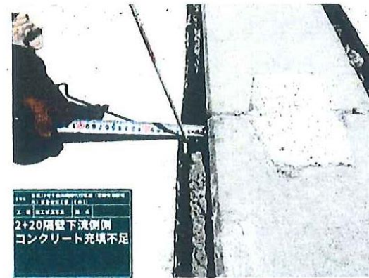
目地施工不良
