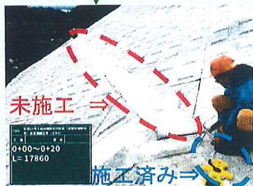
法留基礎未施工(下流側)
