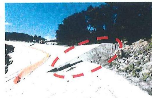
端部の処理不備(上流側)
